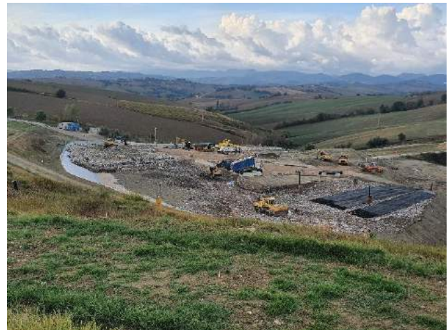
Abbancamento rifiuti nelle apposite celle
